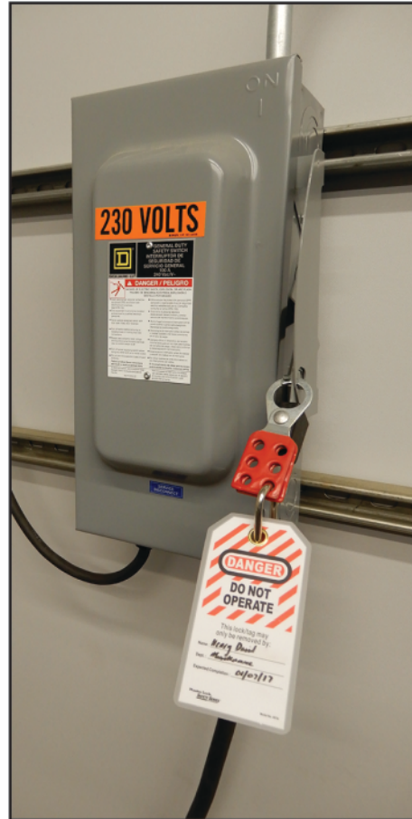
Figura 1-3: Ejemplo de un mecanismo de Bloqueo/Etiquetado en un panel de entrada de suministro eléctrico
