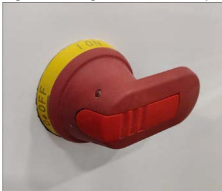
Figura 2-1: El gabinete eléctrico principal
