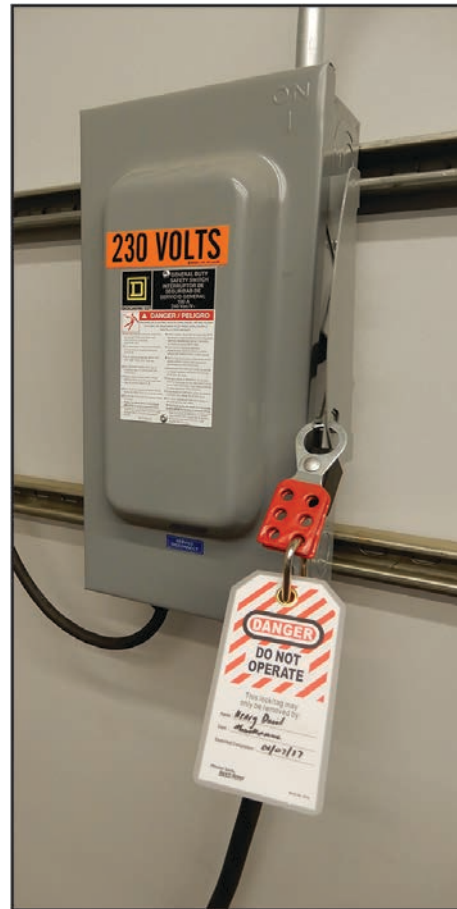
Figura 2-3: Ejemplo de un mecanismo de Bloqueo/Etiquetado en un panel de entrada de suministro eléctrico
