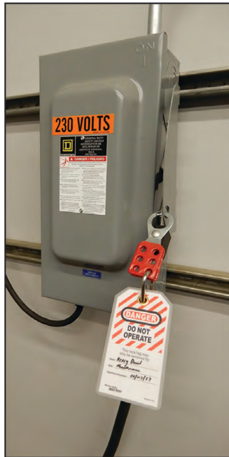
Figura SEGURIDAD-5: Ejemplo de un mecanismo de Bloqueo/ Etiquetado en un panel de entrada de suministro eléctrico
