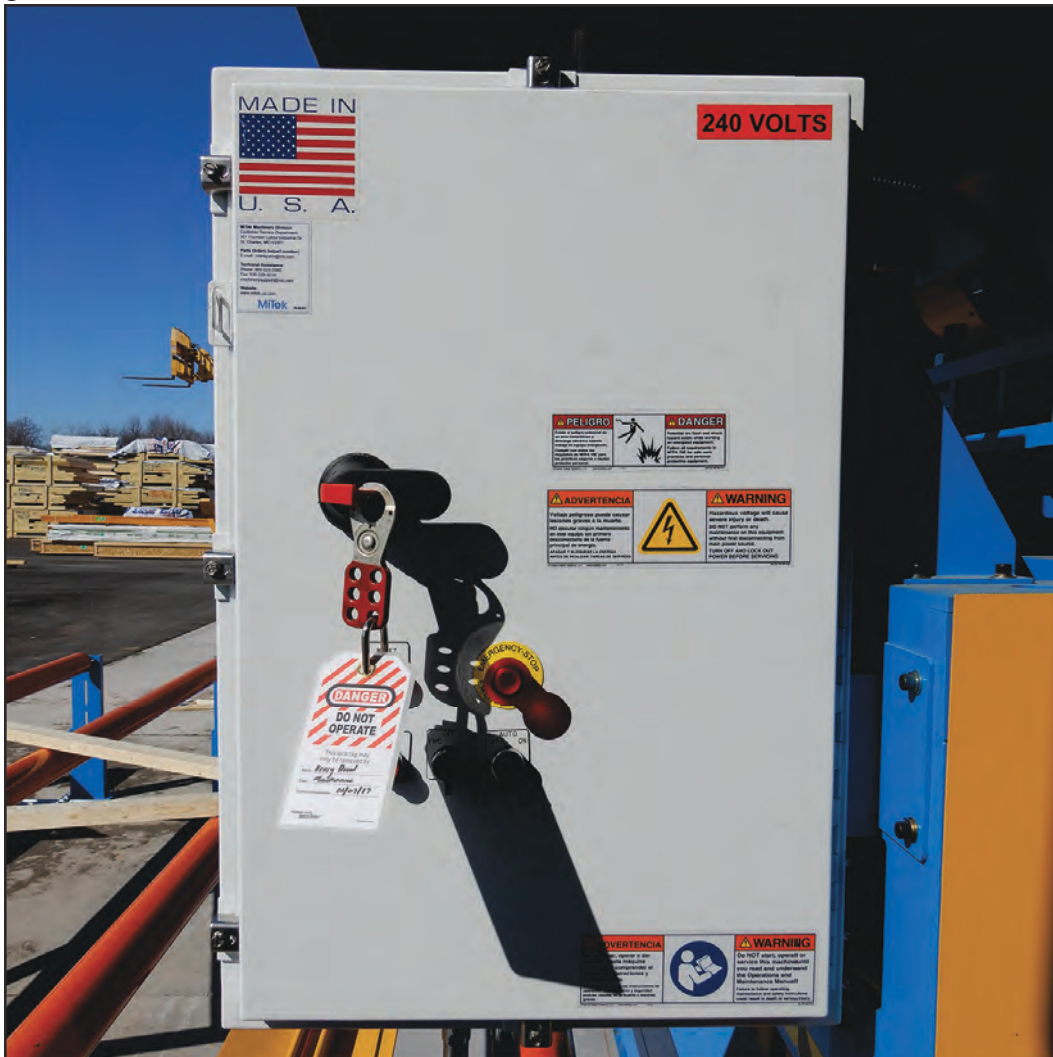
Figura SEGURIDAD-4: Ejemplo de un mecanismo de bloqueo y etiquetado en un gabinete eléctrico
