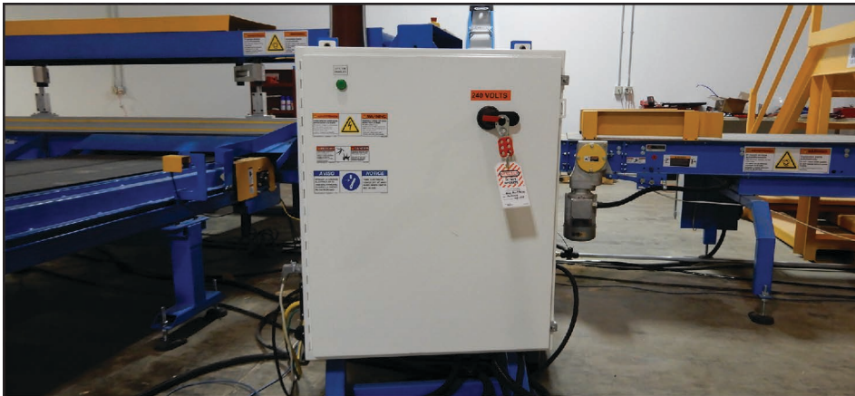
Figura SEGURIDAD-2: El gabinete eléctrico principal
