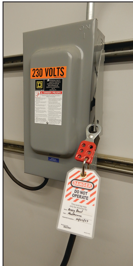
Figura SEGURIDAD-3: Ejemplo de un mecanismo de Bloqueo/ Etiquetado en un panel de entrada de suministro eléctrico
