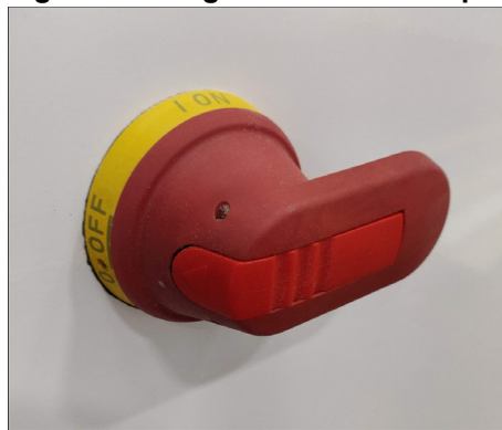
Figure 2-1: El gabinete eléctrico principal
