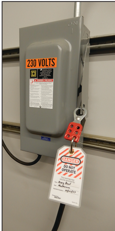
Figura SEGURIDAD-2: Ejemplo de un mecanismo de Bloqueo/Etiquetado en un panel de entrada de suministro eléctrico
