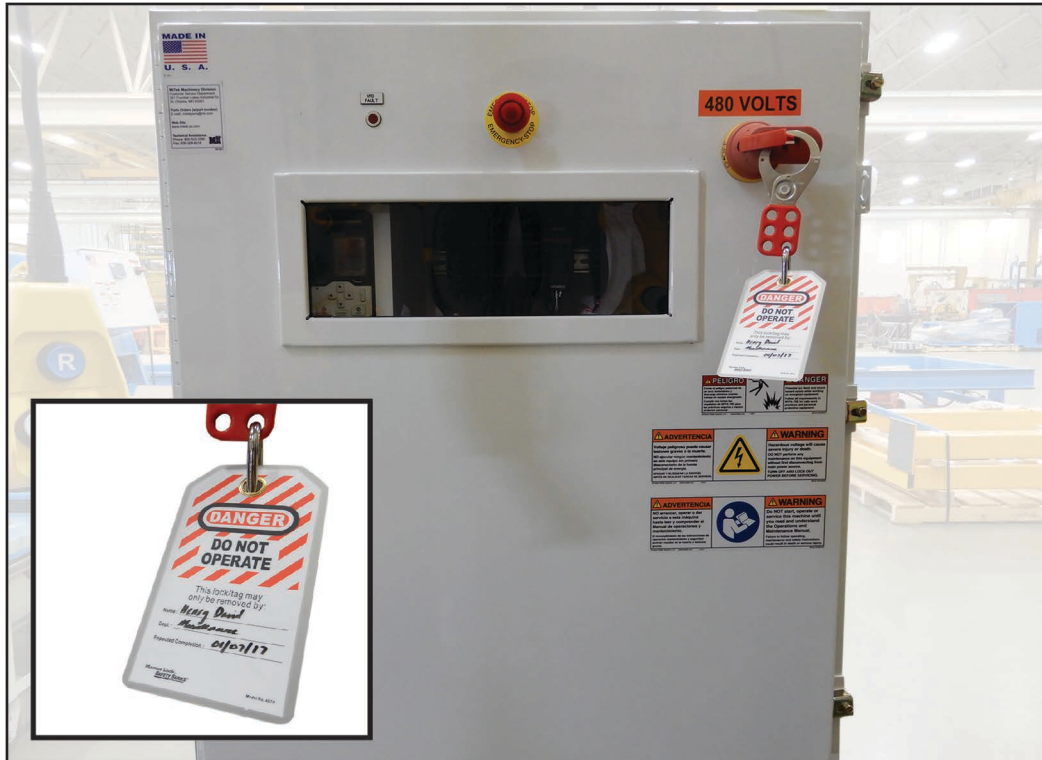
Figura SEGURIDAD-1: Mecanismo de bloqueo/etiquetado en un gabinete eléctrico principal
