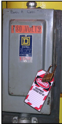
Figure SAFETY-2: Bloqueo/Etiquetado del panel de fuente de alimentación
